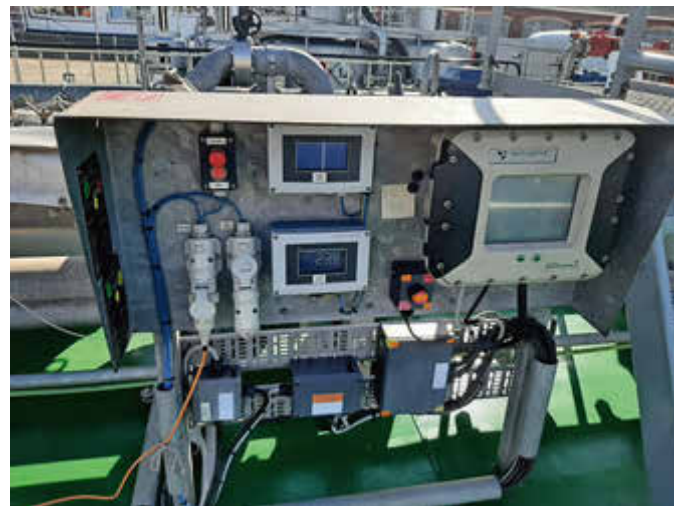
Zu sehen sind die Komponenten zur Verarbeitung des elektronischen Volumenmessung und die Anzeige des gemessenen Volumens bei Abgabe – in diesem Fall in die Normalmessbehälter.
