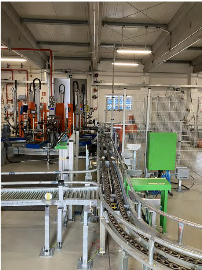
Die Abfüllanlage mit Zuführung
